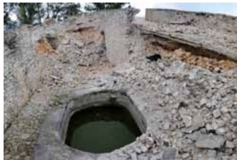
• La cour centrale après le séisme
