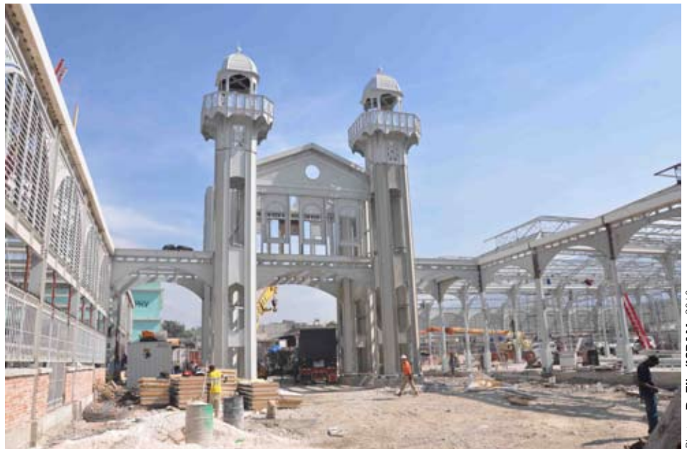
• Jour J-44 : Erection du pavillon central du Marché Hyppolite au 1er décembre 2010
