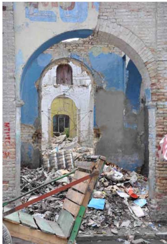
• Ruines d'une halles à la [ZC] de Port-au-Prince (Photo : ISPAN • 2011)
