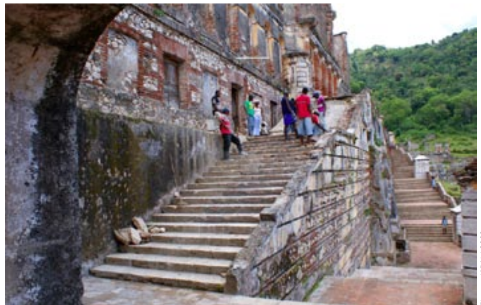
• Le mur de soutènement de la troisième volée (partie Est) du Palais du Roi à Sans-Souci
